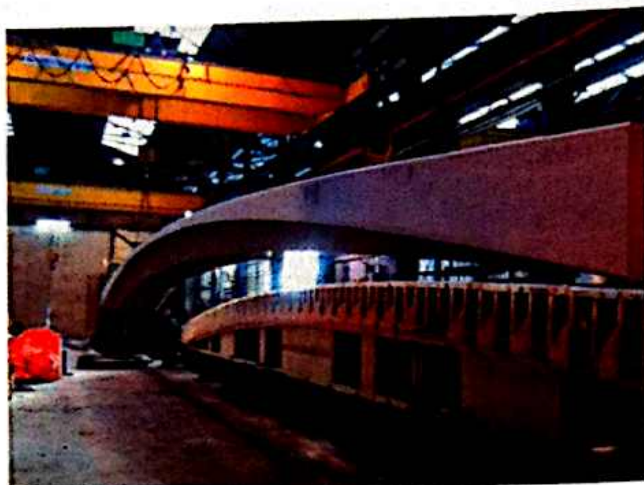
Fig. 2 Goosenbridge in Utrecht, Precast elements: Romein Beton, NL, material design: G.tecz, Kassel
